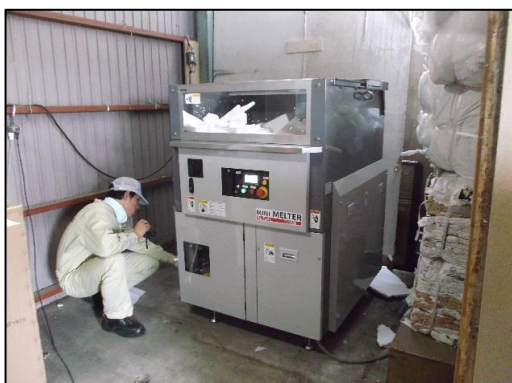
RE-E201設置風景
