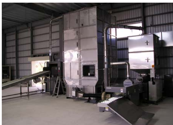
RE-1201全容 (破碎機・ストックタンク・減容機)
